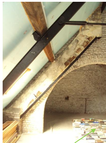
Photo 4 Grenier, poussière de chantier
