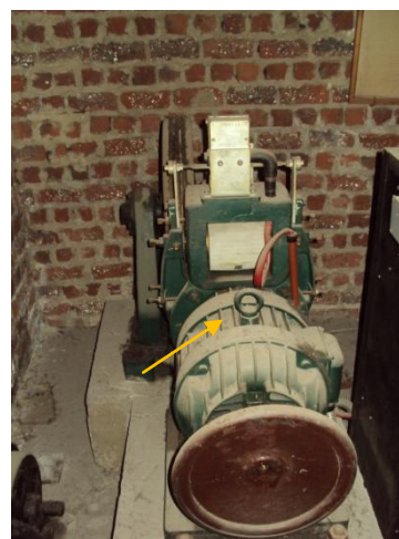
Photo 4 Ancien hôtel communal, machinerie d'ascenseur
