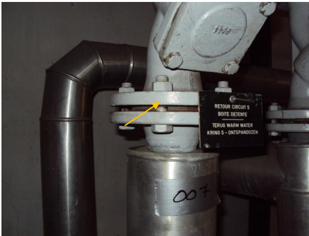
Photo 5 Ancien hôtel communal, chaufferie
